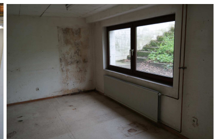
Feuchte im Keller
